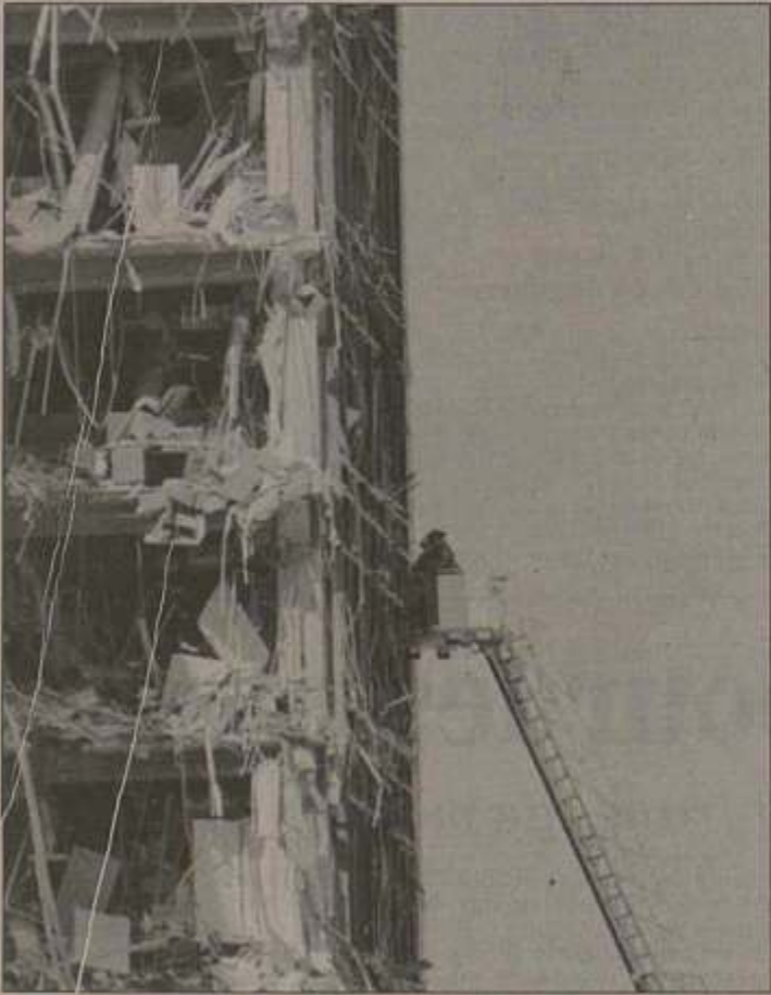
A l'aide d'élevateurs à nacelle, les sauveteurs cherchent les victimes dans le bâtiment éventré.
